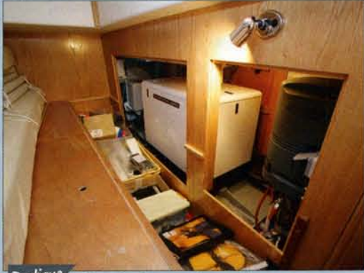
Pratique Entre les deux cabines arrière, une zone technique peut accueillir les équipements lourds : ici un dessalinisateur et un groupe.
